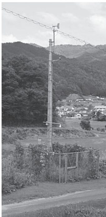
馬木農村広場近くに設置されている送信設備
