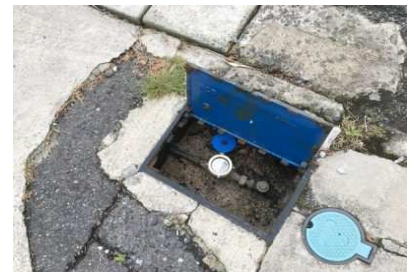
漏水の確認 (水道メーター)
