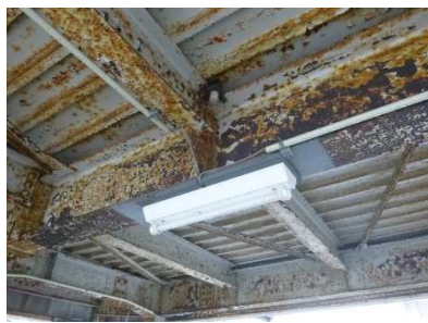
照明器具の劣化
