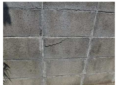
ブロック塀のひび割れ
