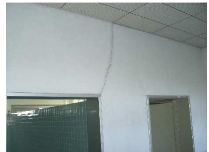
壁のひび割れ
