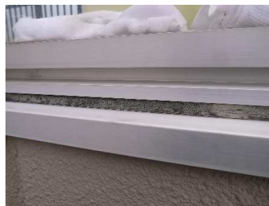
シーリングの劣化
