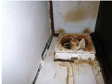
換気扇の劣化
