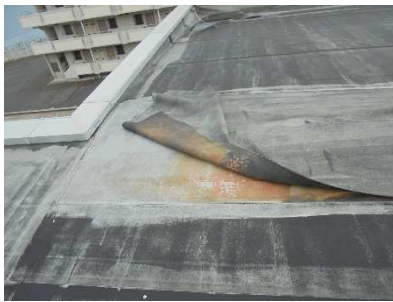
防水層のはがれ
