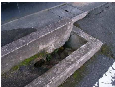
排水側溝の破損
