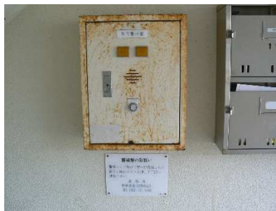
屋外盤類の錆
