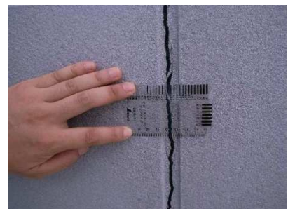
目地シーリングの亀裂
