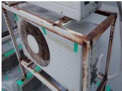
室外機の腐食
