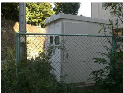
受変電設備（キュービクル）
