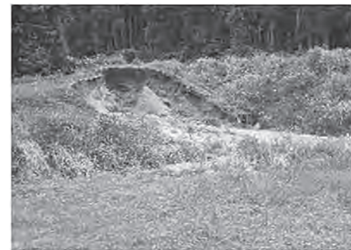
7月12日 農地の土砂崩れ
