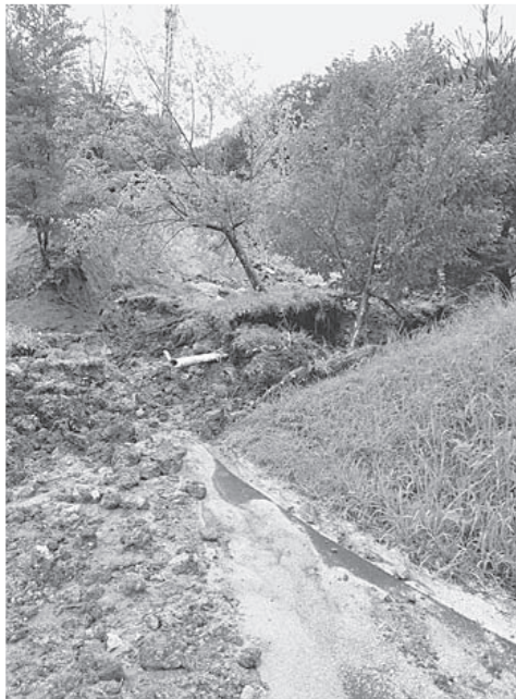
8月14日 田んぼ法面の崩落
