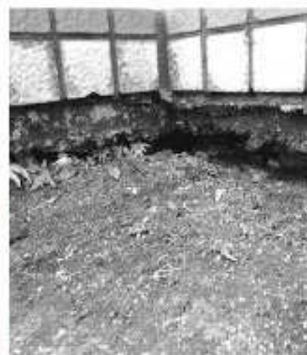
大きく隙間が生じた地盤
