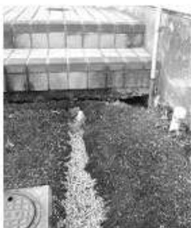
雨水が入り込む隙間
