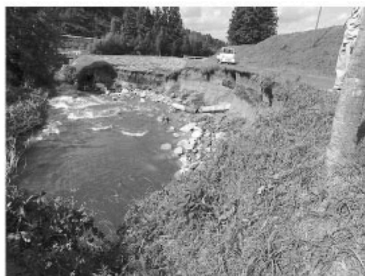
9月30日被災の馬木地区の矢入川（町道矢入東線）
