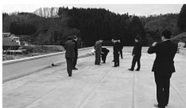
元中学校校舎の布勢小学校 雨漏りもあるため屋上にて確認
