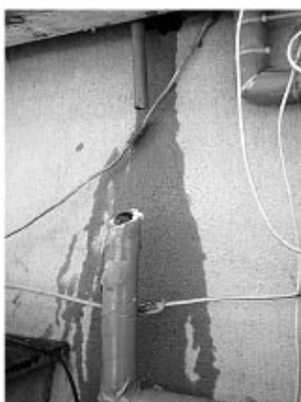
多発した水道管破損事故
