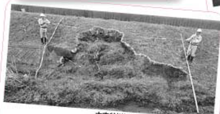
大内谷川護岸の崩落(八川大谷地区)
