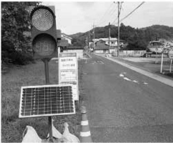
要望が多い町道の修繕（布勢小学校前）
