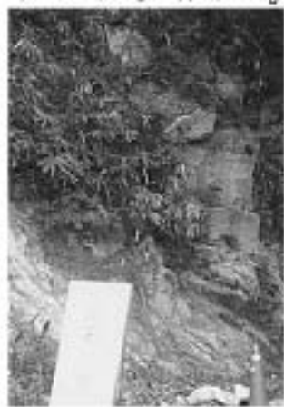
落石の危険が大きい大曲下線
