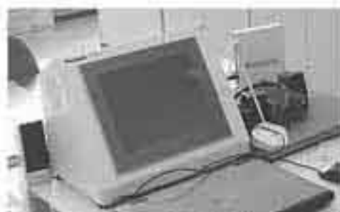
横田庁舎の遠隔制御装置
