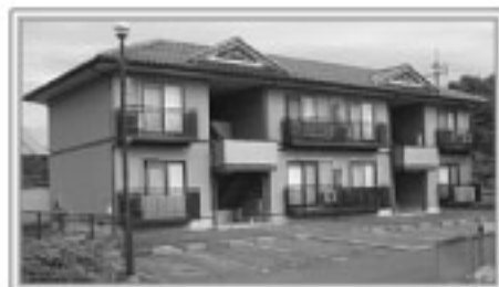
屋根の腐食が確認された公社单身住宅
