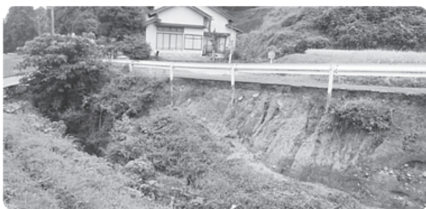
道路崩壊箇所（八代・郡線）
