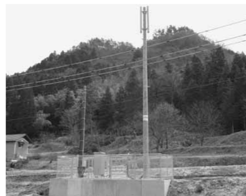
加食基地局の鉄塔
