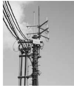
道の駅おろちループに設置したアンテナ
