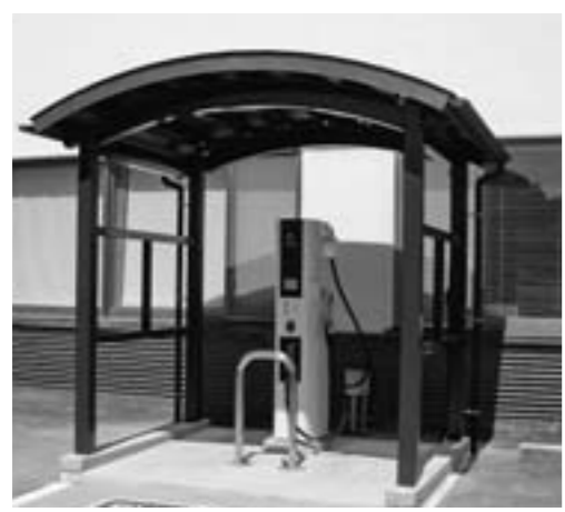
▲設置された電気自動車用充電器
