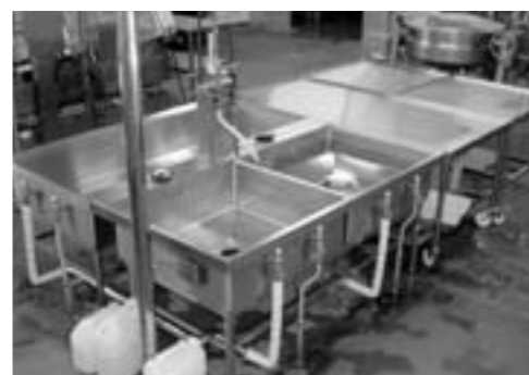
▲調理室の洗浄用シンク
